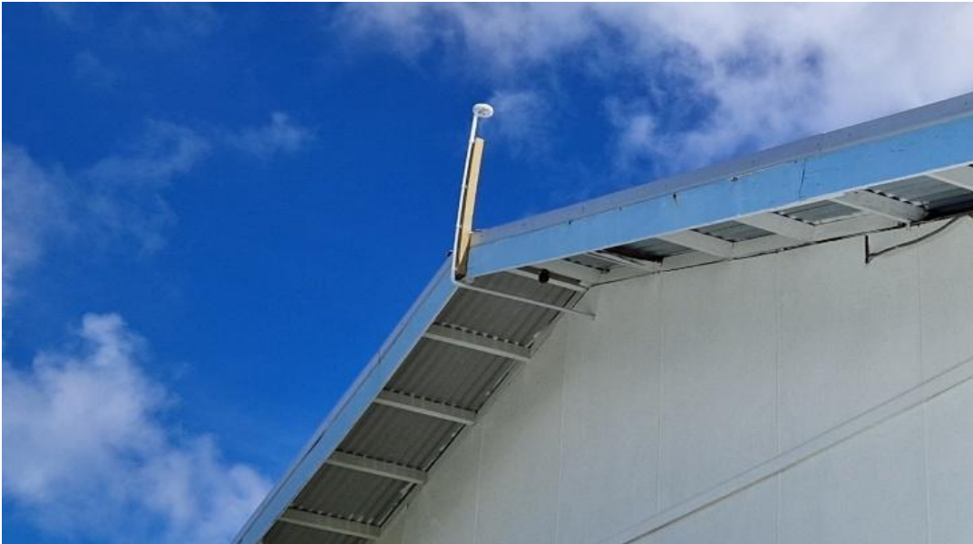
Abbildung 13: Wetterstation auf dem Dach des Titikaveka Colleges 90
